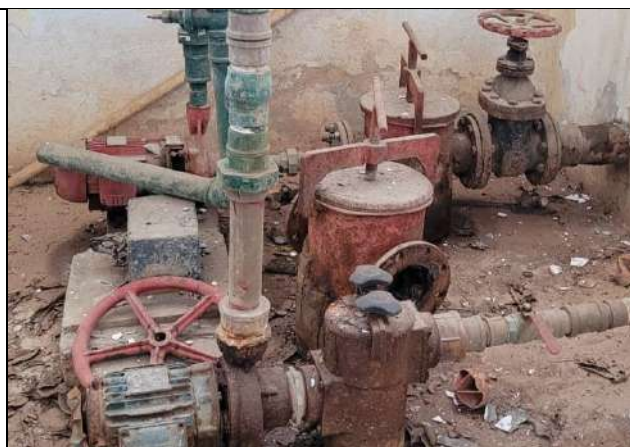
FOTO 36 – CASA DE MÁQUINAS DA PISCINA RECREATIVA
