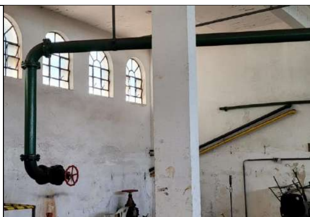
FOTO 40 – CASA DE MÁQUINAS DA PISCINA RECREATIVA
