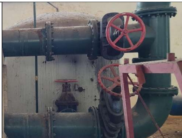
FOTO 34 – CASA DE MÁQUINAS DA PISCINA RECREATIVA
