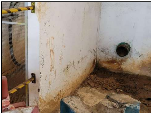
FOTO 49 – CASA DE MÁQUINAS DA PISCINA RECREATIVA
