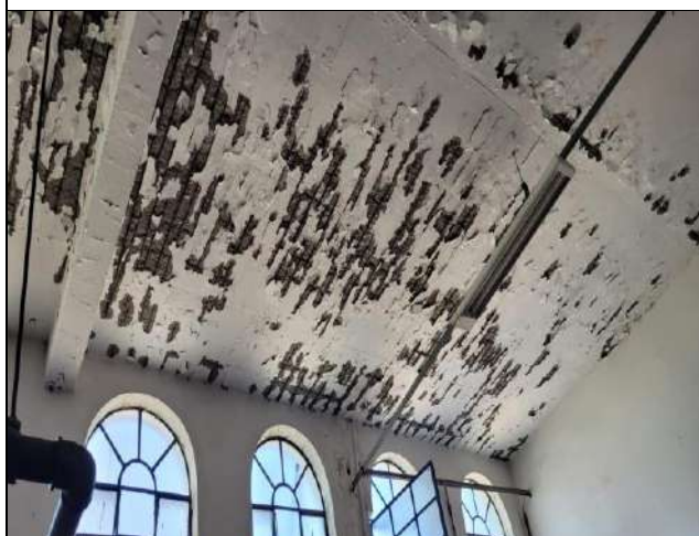
FOTO 67 – CASA DE MÁQUINAS PISCINA RECREATIVA
