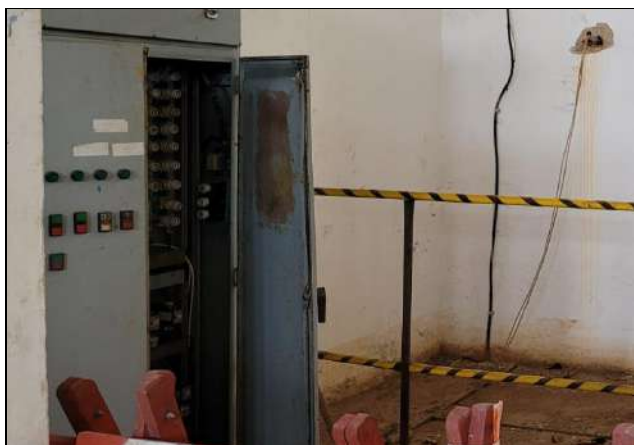
FOTO 47 – CASA DE MÁQUINAS DA PISCINA RECREATIVA
