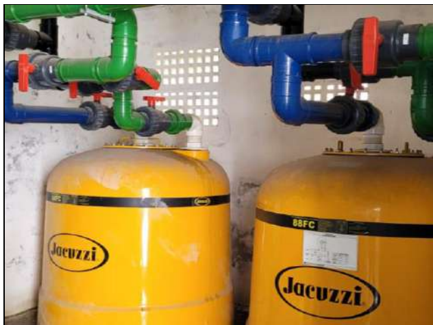
FOTO 37 – CASA DE MÁQUINAS DA PISCINA SEMIOLÍMPICA
