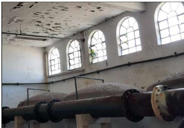
FOTO 45 – CASA DE MÁQUINAS DA PISCINA RECREATIVA
