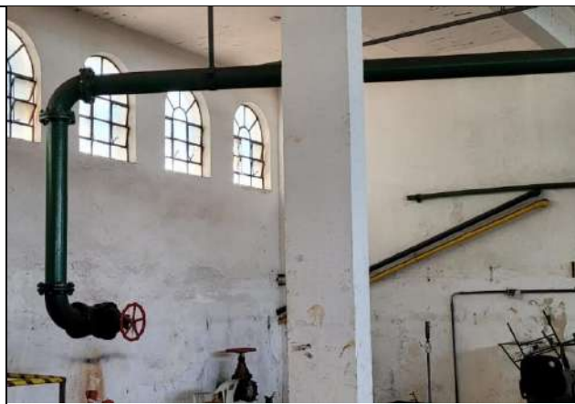
FOTO 46 – CASA DE MÁQUINAS DA PISCINA RECREATIVA
