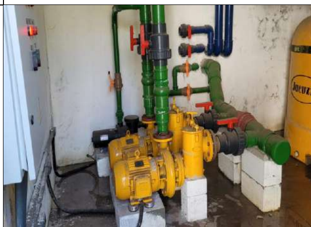
FOTO 44 – CASA DE MÁQUINAS DA PISCINA SEMIOLÍMPICA
