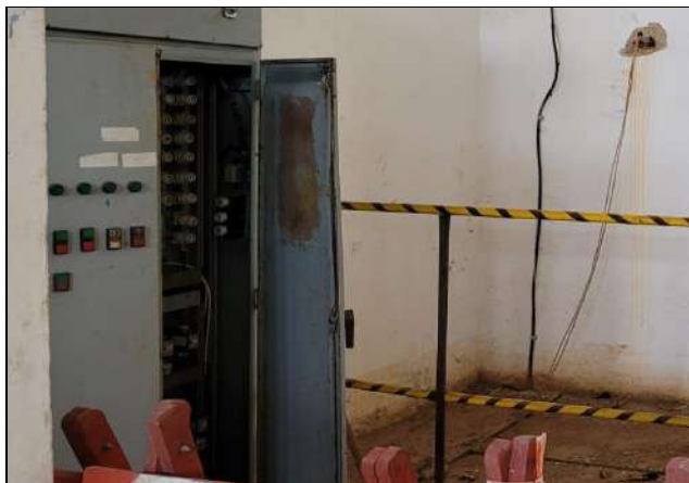
FOTO 41 – CASA DE MÁQUINAS DA PISCINA RECREATIVA
