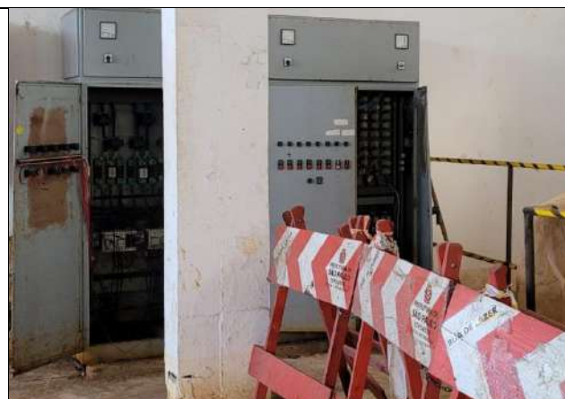
FOTO 48 – CASA DE MÁQUINAS DA PISCINA RECREATIVA
