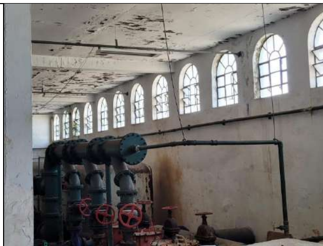
FOTO 38 – CASA DE MÁQUINAS DA PISCINA RECREATIVA
