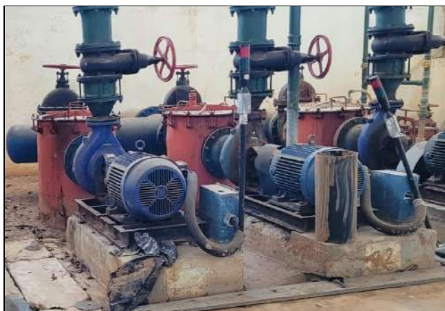
FOTO 35 – CASA DE MÁQUINAS DA PISCINA RECREATIVA
