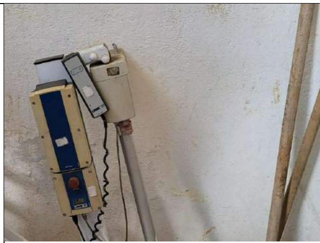
FOTO 50 – CASA DE MÁQUINAS DA PISCINA RECREATIVA
