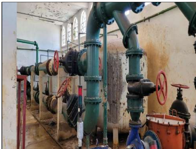
FOTO 69 – CASA DE MÁQUINAS PISCINA RECREATIVA
