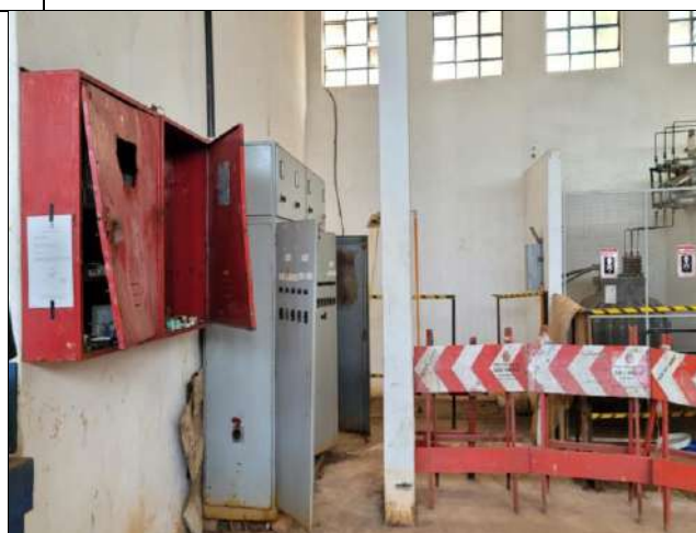
FOTO 68 – CASA DE MÁQUINAS PISCINA RECREATIVA
