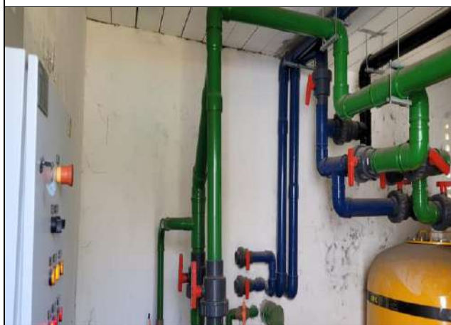
FOTO 43 – CASA DE MÁQUINAS DA PISCINA SEMIOLÍMPICA
