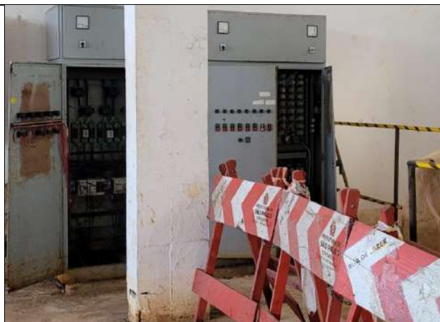
FOTO 42 – CASA DE MÁQUINAS DA PISCINA RECREATIVA
